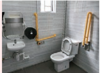
廁所安裝適當扶手
