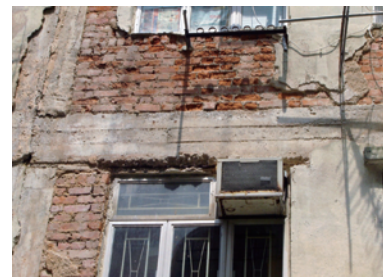
樓宇外牆石屎剝落
