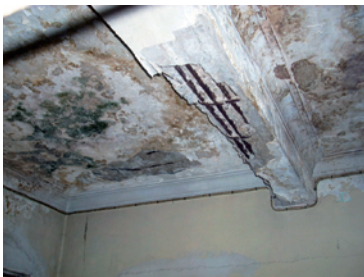
天花石屎嚴重剝落至鋼筋外露
